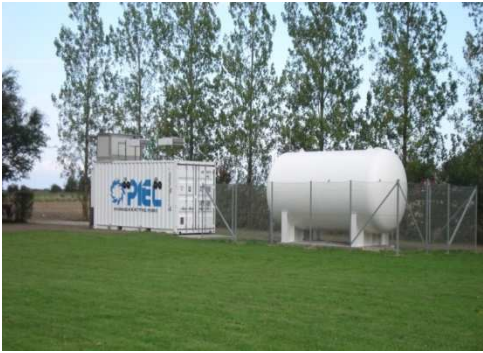
Elektrolyser og brintlager, Vestenskov.
