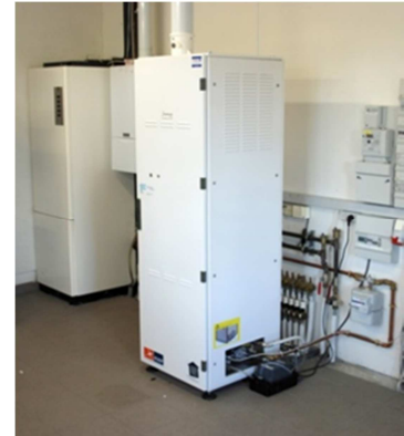
Installation, Varde. Beholderen bagerst er et varmelager til solvarme.
